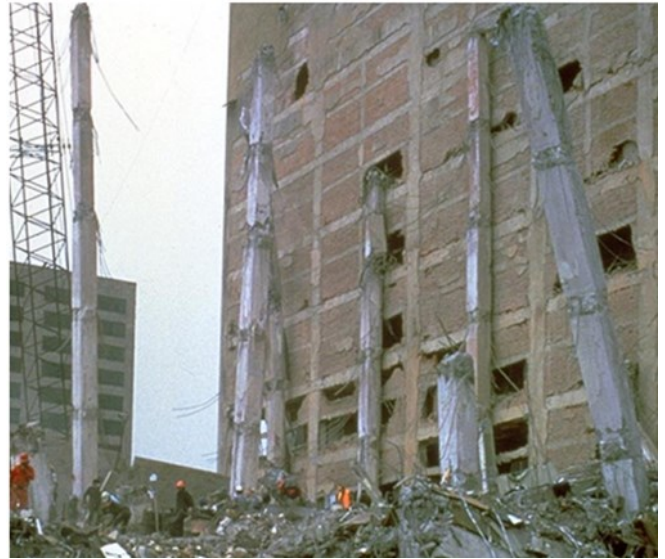
Slika 5 – Kompletni kolaps tavanica zgrade konstrukcijskog sistema “flat slab frame” (EERI, 1985)
