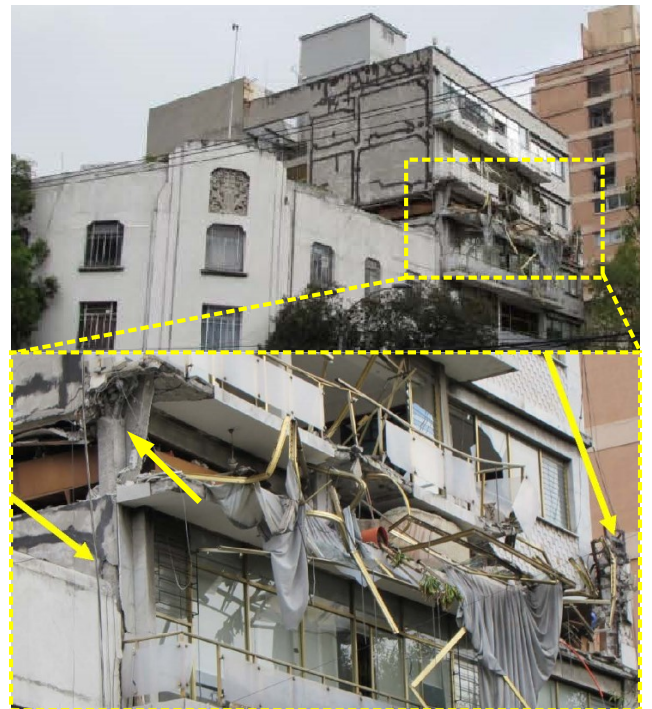
Slika 9 – Kolaps šestog sprata usled efekta fleksibilnog sprata i sudaranja sa susednim objektom (Ruiz-García, 2017)
