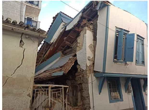
Teško oštećena višespratna armirano-betonska zgrada u Izmiru, Turska (levo) i zidana kuća na ostrvu Samos, Grčka (desno) nakon zemljotresa od 30.10.2020 (izvor: bbc.com , greekreporter.com ).
